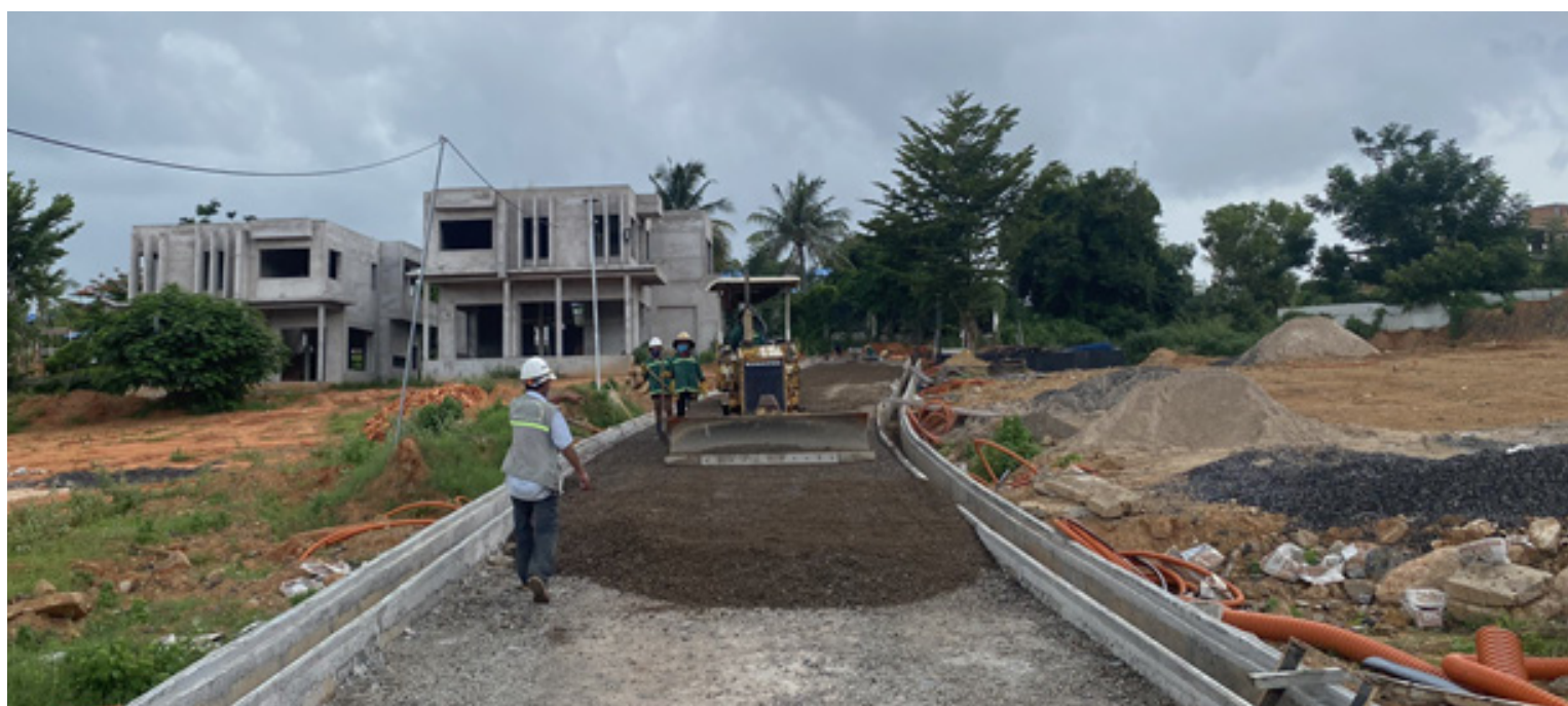
Casa Marina Mũi Né đã hoàn tất thi công trên 90% hạ tầng nội khu, tiếp đến sẽ triển khai thi công đồng loạt các căn villa.
